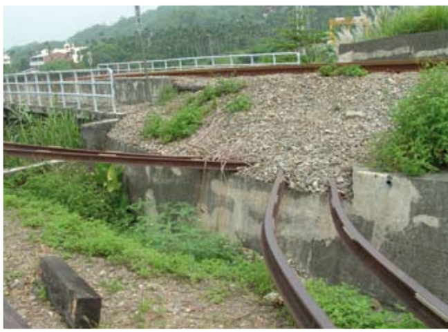
➔ Binari piegati in senso sia verticale sia orizzontale dal sisma che ha colpito Taiwan il 21 settembre 1999 (magnitudo 7,6 della scala Richter).
